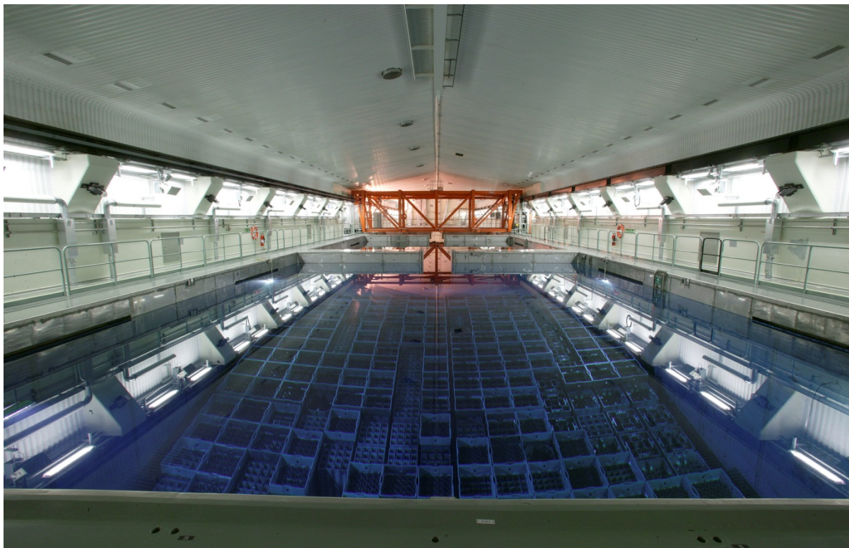
Figur 3-5. Förvaringsbassäng i Clab.
